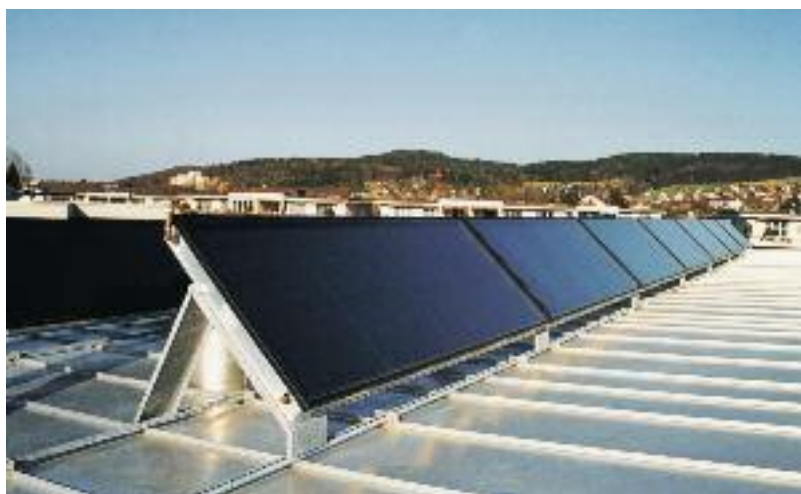
COBRA-Kollektoren für QUICKSOL® im Mehrfamilienhaus.
